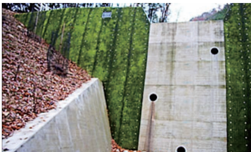
管理の難しい壁面の緑化にも問題なく使える
