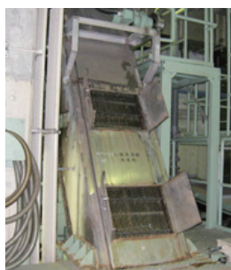
浄化センターし渣掻揚機
