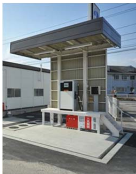
BDF注油取扱所
