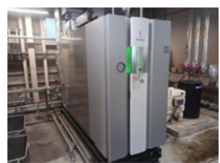
高性能ボイラ
