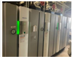
高性能ボイラ
