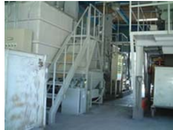
無機排水処理設備
