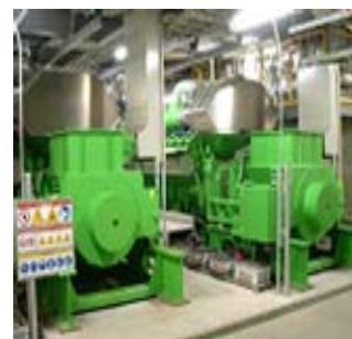
ガスエンジン
