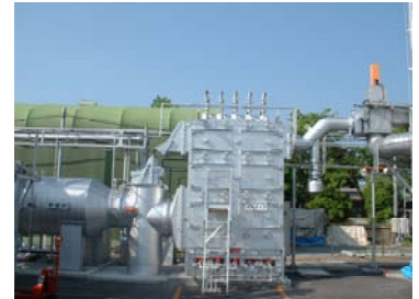
排ガス処理設備
