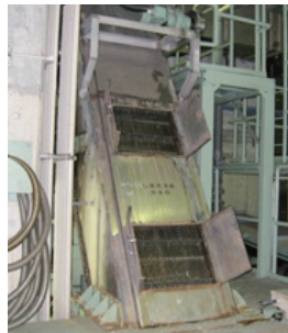
浄化センターし渣掻揚機
