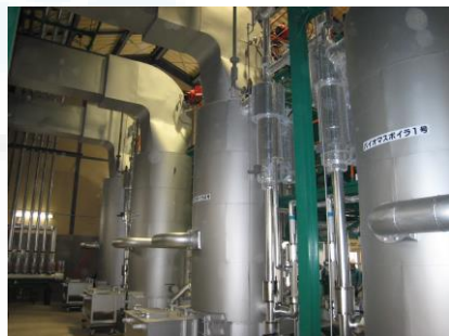
図 バイオマスボイラ 写真提供:加美町様
