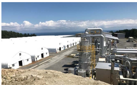
左：栽培ハウス 右：木質バイオマスボイラ
