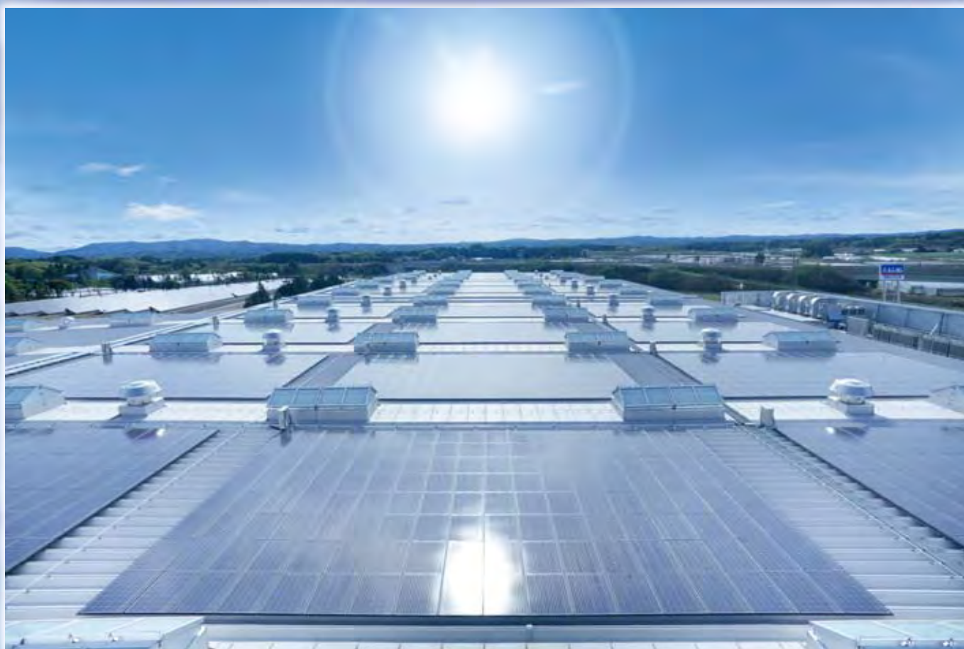
(レンゴー(株)福島矢吹工場 太陽光発電設備)
