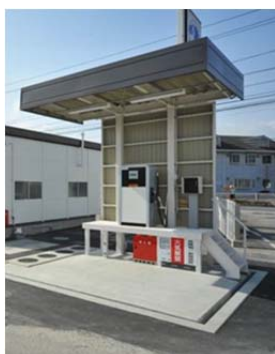
BDF注油取扱所
