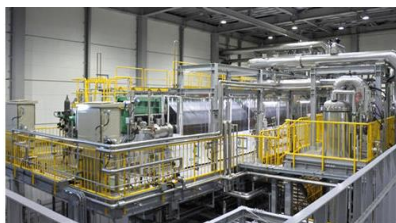
10MWの水電解装置
