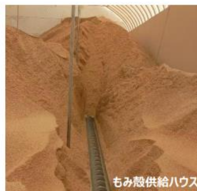
もみ殻バイオマスボイラ
