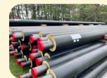
熱導管が村内を縦断 宿泊・福祉施設等で熱利用
