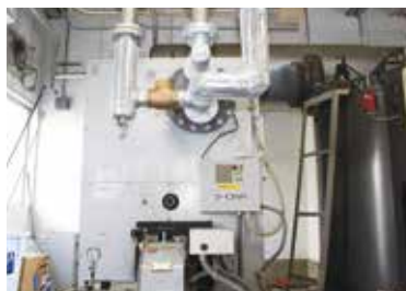
▲既設の重油焚きボイラー
