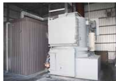
▲タイヤボイラー本体(右)と貯湯タンク(左)
