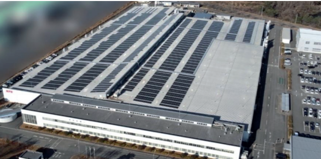
工場屋上へ設置したメガソーラーシステム（出力:2,427kW）
