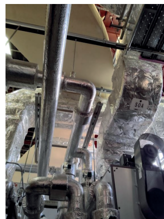
断熱施工された配管
