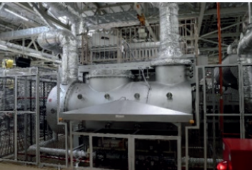
アフターバーナー炉 (脱脂炉排出ガスの無害化)
