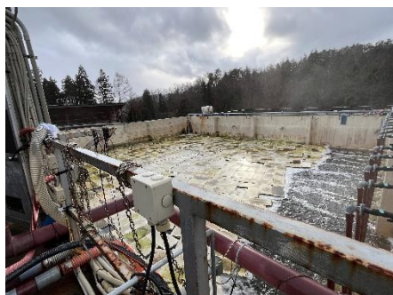
※浸出水処理施設（処理槽写真）
