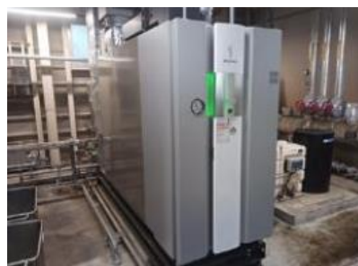
高性能ボイラ
